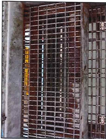
Local: Lança Item # 50: corrosão no corrimão e na estrutura da passarela de acesso à lança.
