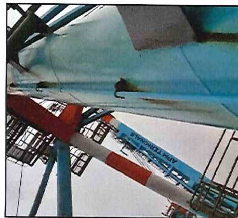
Local: Apex Item # 60: Corrosão nas vigas de sustentação do Apex.
