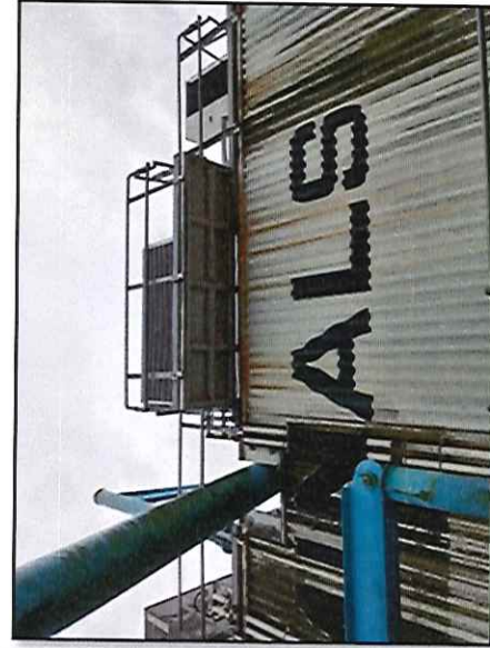
Local: Sala de Máquinas Item # 29: pontos de oxidação na casaria da sala de máquinas.
