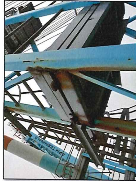
Local: Estrutura (geral) Corrosão nas plataformas de inspeção dos braços de sustentação da lança.
