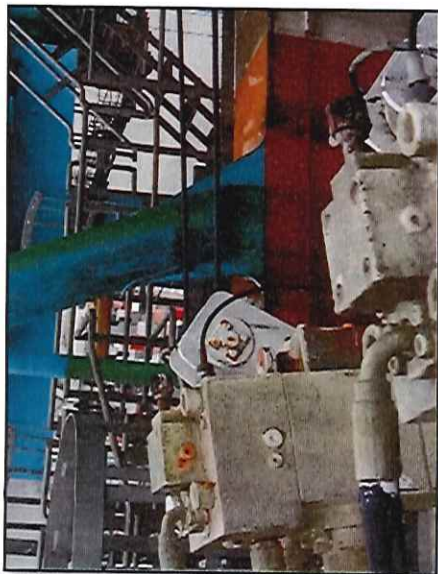
Local: Plataforma do TLS Item # 38: corrosão nas válvulas dos cilindros hidráulicos do TLS.
