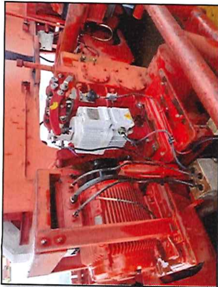
Local: Gantry Item # 02: avaria na tampa de proteção do Gantry 03.
