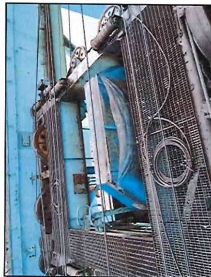
Local: Trolley Item # 43: lona de proteção do enrolador do cabo elétrico do spreader está rasgada.
