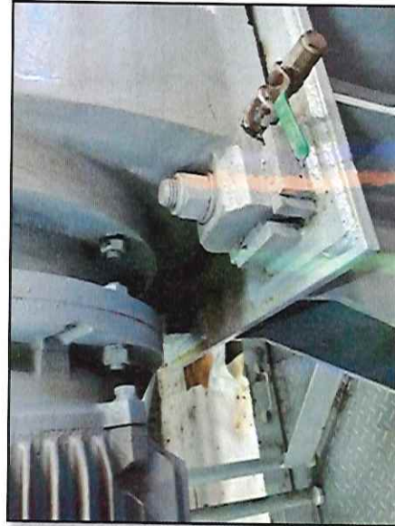
Local: Sala de Máquinas Item # 23: vazamento de óleo hidráulico nos redutores do dromo auxiliar de troca de cabos de aço.
