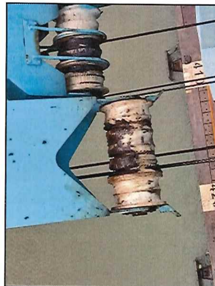
Local: Trolley Item # 46: roletes de apoio dos cabos de aço com desgaste.
